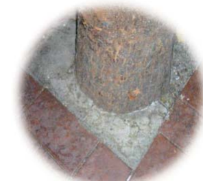
Don't pour concrete into the root zone 切勿把混凝土 倒進根部範圍
