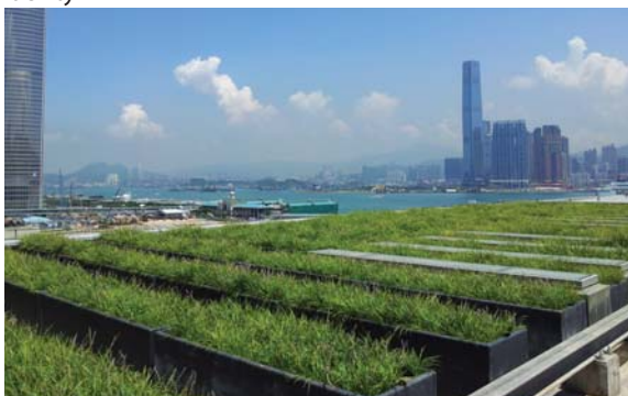
位於政府總部的粗放型屋頂綠化 Extensive green roof at Central Government Offices
